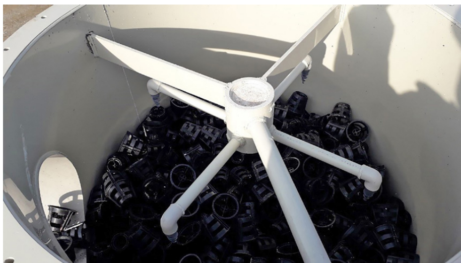
Particolare dell'interno del sistema di lavaggio e dei corpi di riempimento presenti
